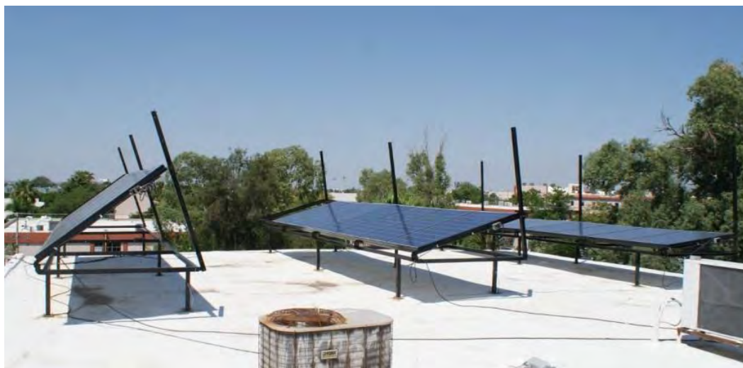
Figura 1. Sistema fotovoltaico en el Departamento de Física.
