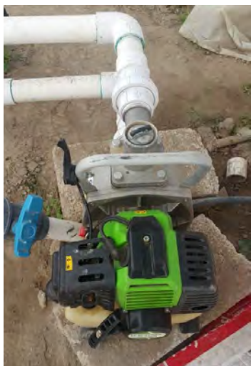
Figura 12 Bomba de 3HP
