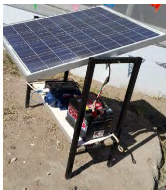
Figura 4 Panel fotovoltaico de 80W
