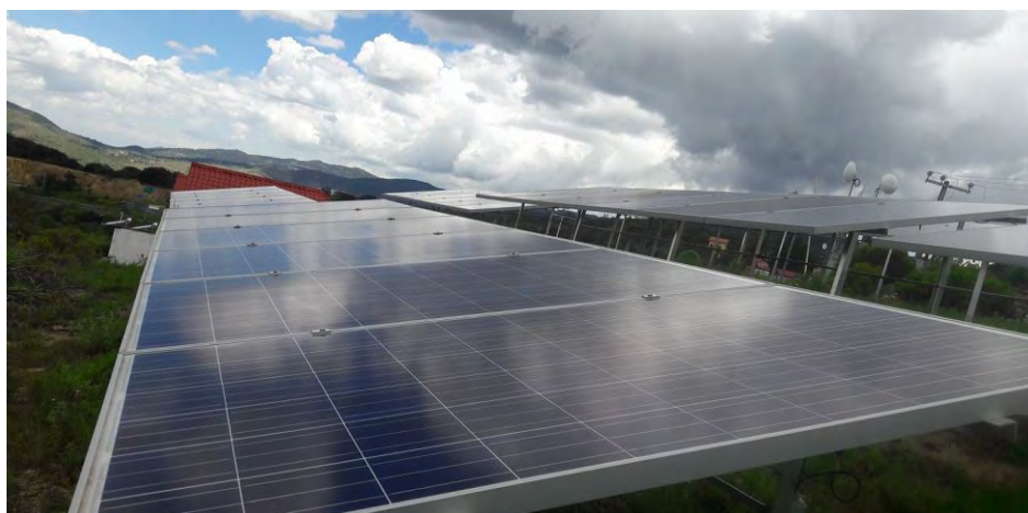
Figura 2. Arreglo fotovoltaicos del sistema, instalado . Fuente. Propia.
