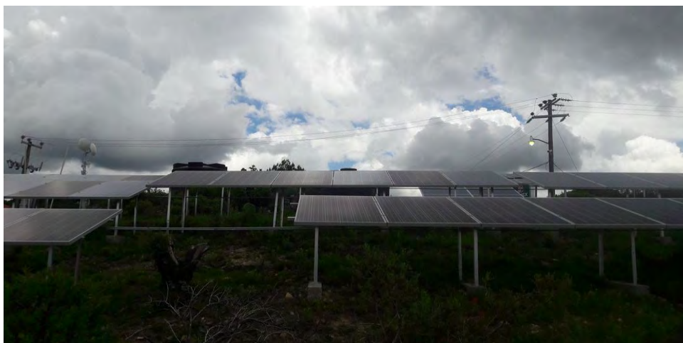
Figura 3. Otra vista de la instalación del sistema, las estructuras están sujetas a unas zapatas de concreto, el cableado se hizo a través de tubo conduit galvanizado de 1 pulgada para proteger el cableado de la exposición del medio ambiente.
