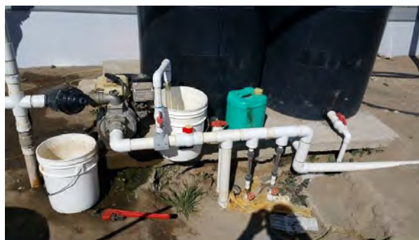
Figura 13 Bomba de 5Hp
