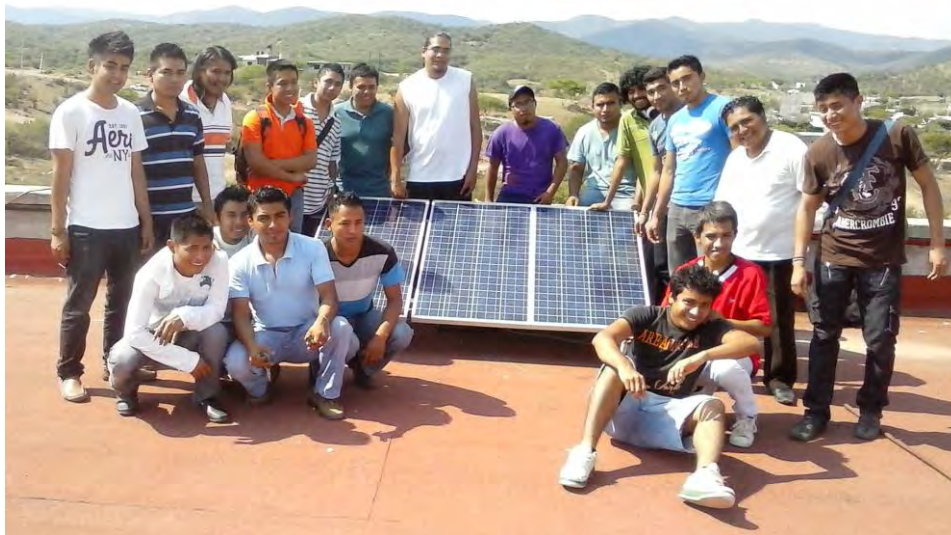
Figura 6. Módulo de paneles solares instalado.
