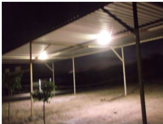
Figura 7. Lámparas de LED's funcionando con el SSFV.
