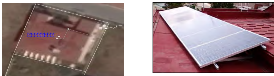
Figura 3. Lugar de ubicación del sistema fotovoltaico y el sistema ya instalado.
