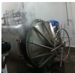
Fig. 1. Inyección de vapor en la autoclave.
