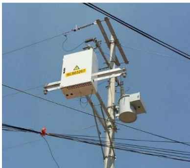
Figura 3.- Gabinete GMM colocado en poste.
