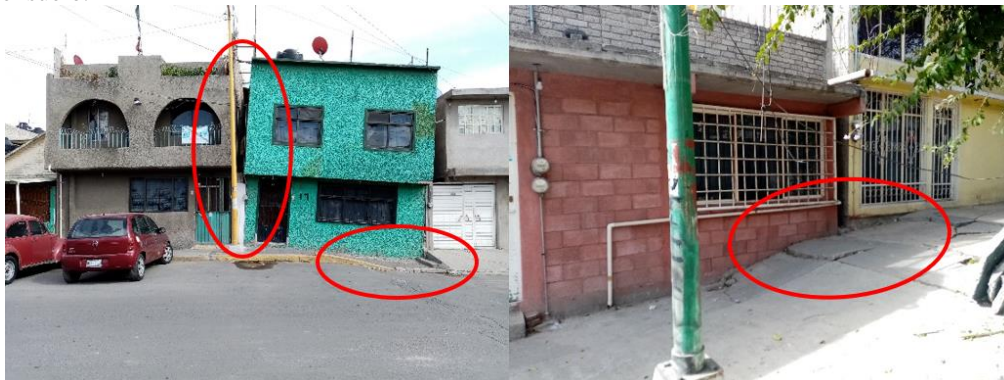
Figura 3. Daños en las viviendas de la U.H. Ermita Zaragoza. Izq. Pérdida de verticalidad y horizontalidad de la vivienda. Der. Niveles diferenciales de viviendas contiguas a partir de nivel de banqueteta. Fotos: Baca, 2020.
