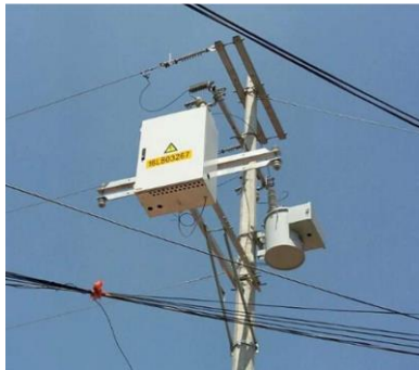
Figura 3.- Gabinete GMM colocado en poste.
