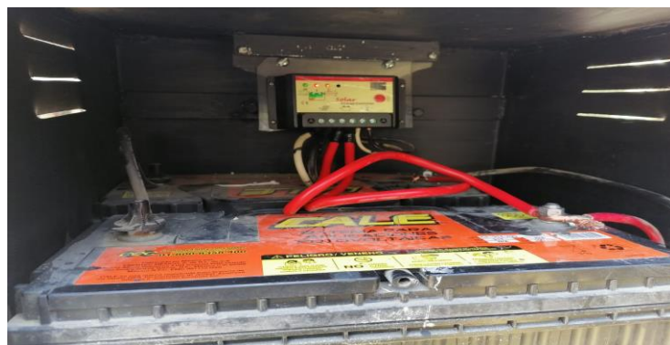
Figura 9 Luminaria LED Solar y Controlador Fuente Propia
