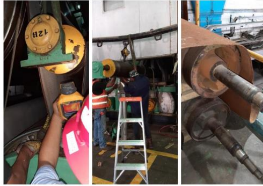
Figura 6. Rodillos de lona tipo B susceptibles de daño por fractura mecánica
