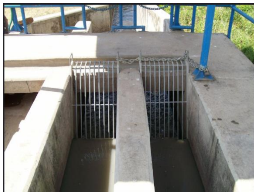
Figura 2. Rejillas para retención de sólidos. Foto: Enrique Padilla Díaz, tomada de: https://www.flickr.com/photos/gepadi/2108286067/in/photostream/
