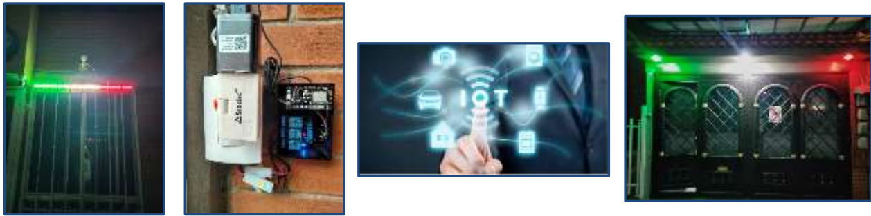
Figura 8. Proyecto del Sistema Domotico Modular Wi-Fi, en funcionamiento real.
