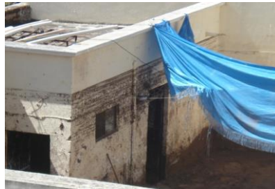
Fotografía 1. Nivel de inundación máximo registrado en la zona urbana.
