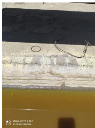
Figura 6 Marca de evaporación de agua residual.
