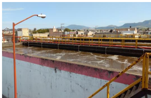
Figura 3. Módulos de tratamiento.
