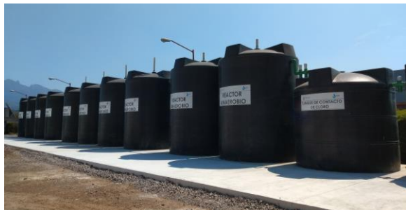
Figura 1. Nueva etapa a base de reactores anaerobios.
