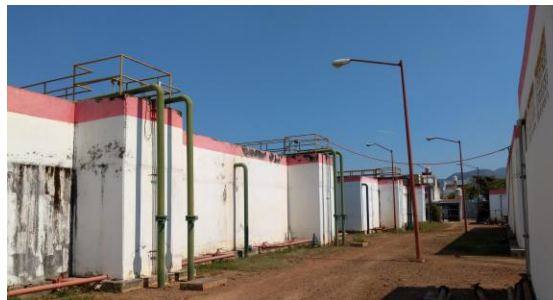
Figura 2. Módulos de tratamiento.
