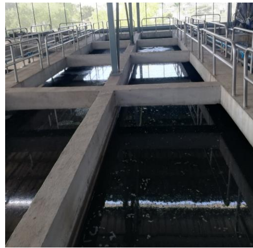
Figura 8. Tanque de homogenización.
