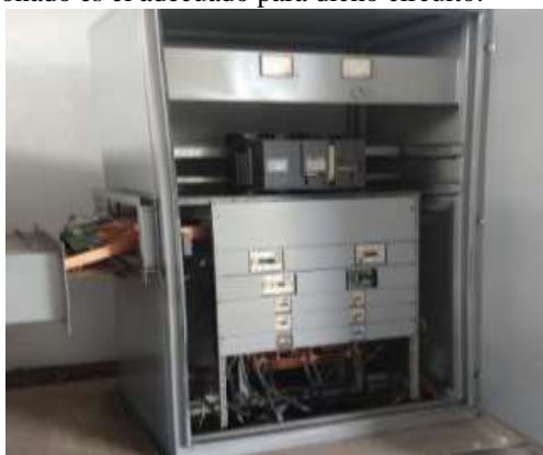
Imagen 2. Transformador del CBTIS 214
