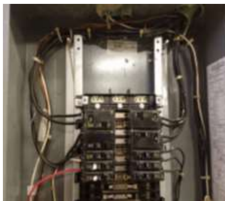
Imagen 3. Muestra de un tablero y conductores
