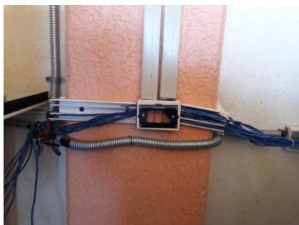
Figura 6. Cableado de centro de cómputo 3 Fuente: Elaboración propia
