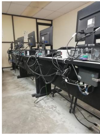
Figura 9. Topología del centro de cómputo 1 Fuente: Elaboración propia
