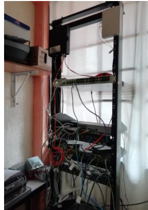
Figura 1. Rack del edificio A Fuente: Elaboración propia
