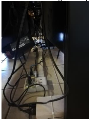
Figura 5. Cableado de centro de cómputo 2 Fuente: Elaboración propia
