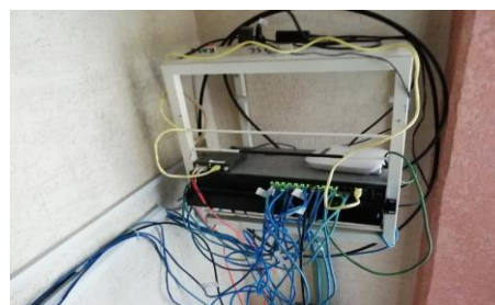
Figura 3. Rack del edificio C Fuente: Elaboración propia
