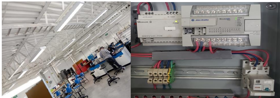
Figura 3. Implementación de proyecto de automatización dentro del laboratorio de automatización y eléctrica.
