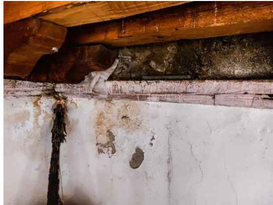
Fig. 5 Humedad presente en el coro. Fotografía: ASS.
