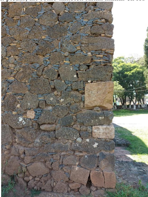
Fig. 6 Fracturas en cadena de ángulo de la torre. Fotografía: ASS.
