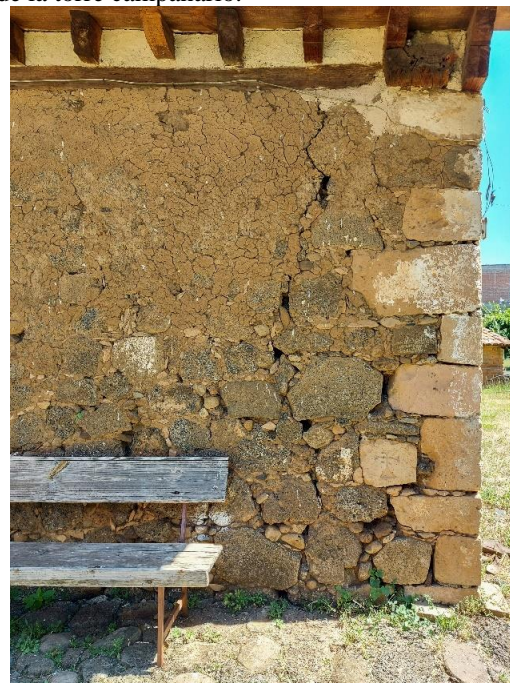
Fig. 7 Fractura en muro de la sacristía. Fotografía: ASS.
