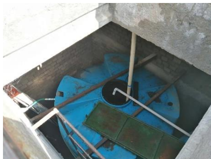
Figura 3. Cisterna con agua tratada. Creación propia.
