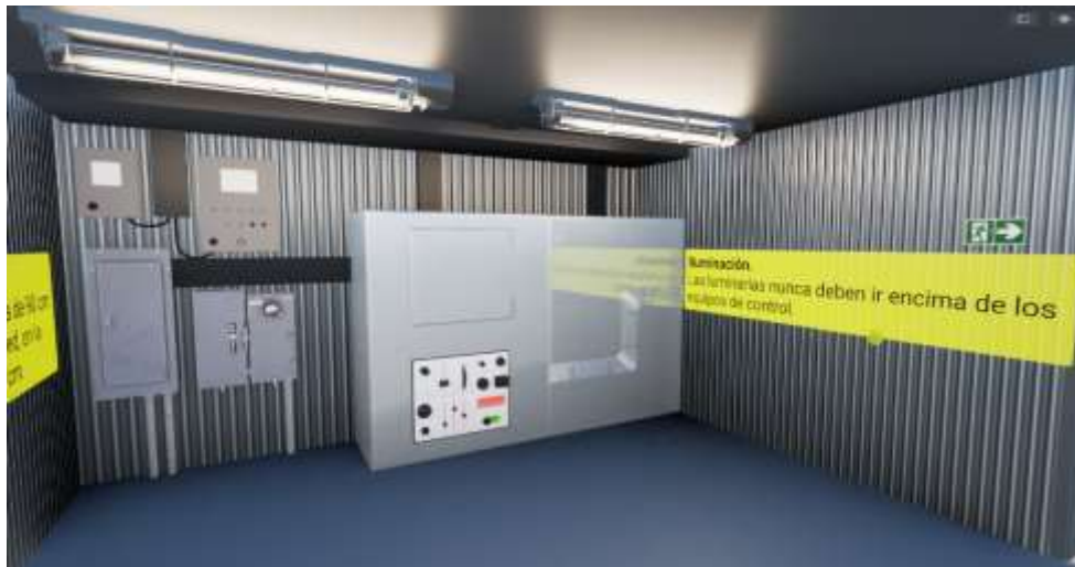
Figura 5. Cuarto de control de la subestación el recorrido de realidad virtual.
