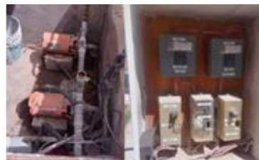
Figura 4. Bomba y gabinete de Cisterna F
