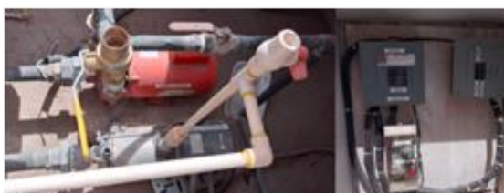
Figura 7. Bomba y gabinete de Cisterna H
