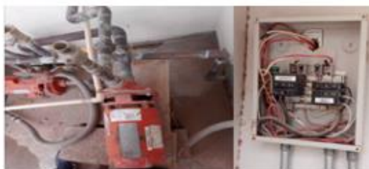
Figura 6. Bomba y gabinete de Cisterna L
