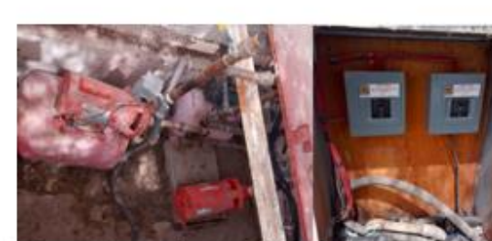
Figura 10. Bomba y gabinete CAF- cafetería
