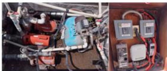
Figura 5. Bomba y gabinete de Cisterna E
