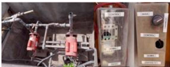
Figura 3. Bomba y gabinete de Cisterna C
