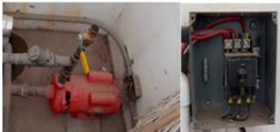
Figura 9. Bomba y gabinete de Cisterna CI (centro de información)
