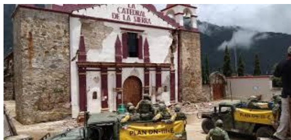
Figura 2. Daños en la Catedral de la Sierra de San Juan Ozolotepec. Fuente: Dixi Oaxaca
