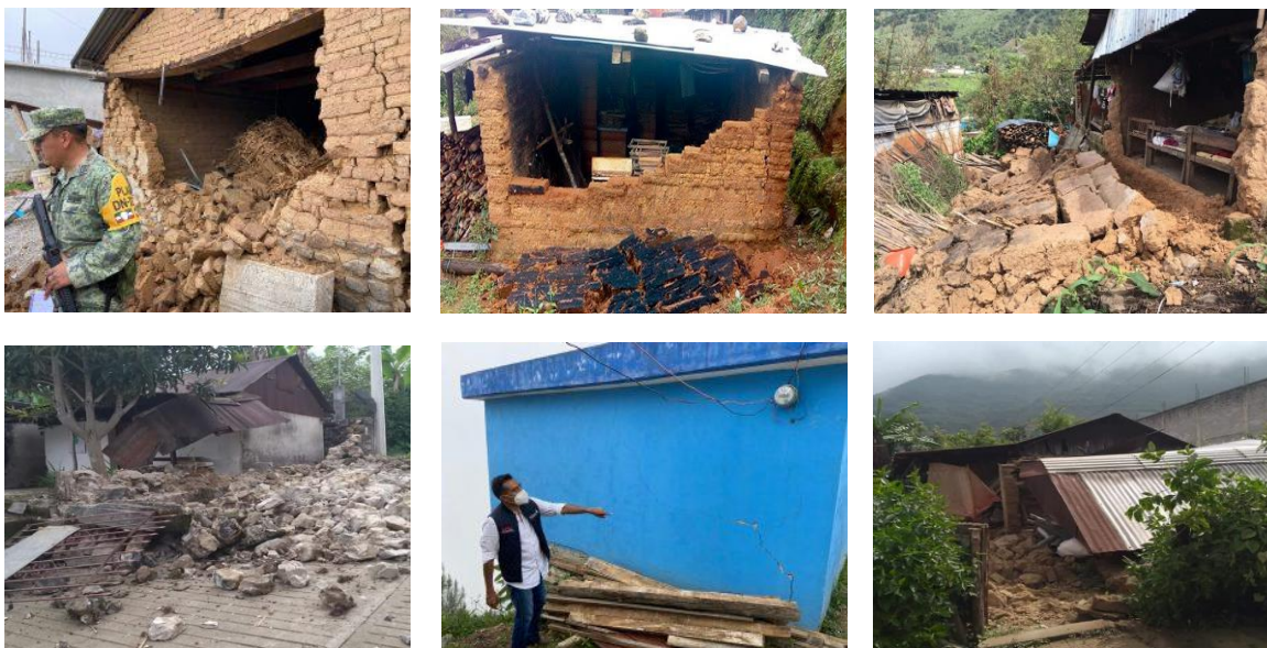
Figura 3. Daños severos en viviendas de Oaxaca altamente vulnerables sísmicamente. Fuente: Gobierno de Oaxaca y usuarios de redes sociales
