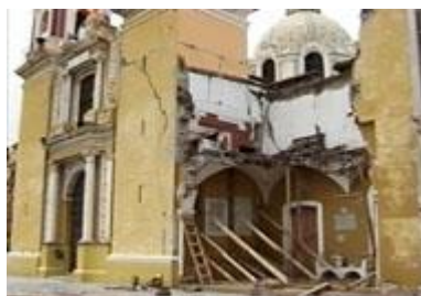
Fig 13. Desplome en Acceso al Claustro muro sur norte
