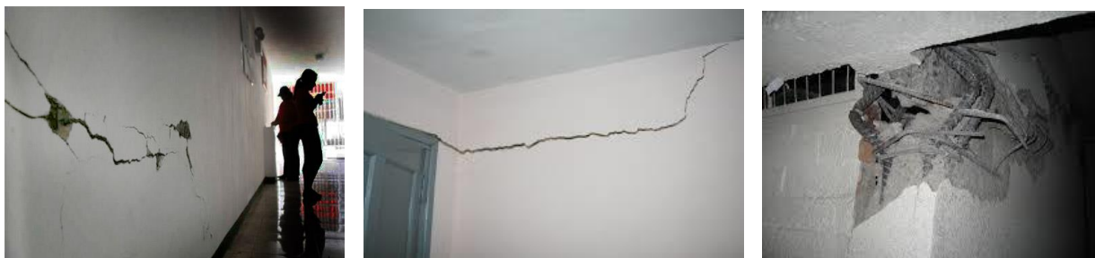
Imágenes 7 Fallas Estructurales
