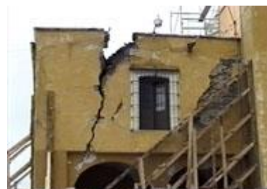
Fig. 14. Desplome en 2o. Piso muro
