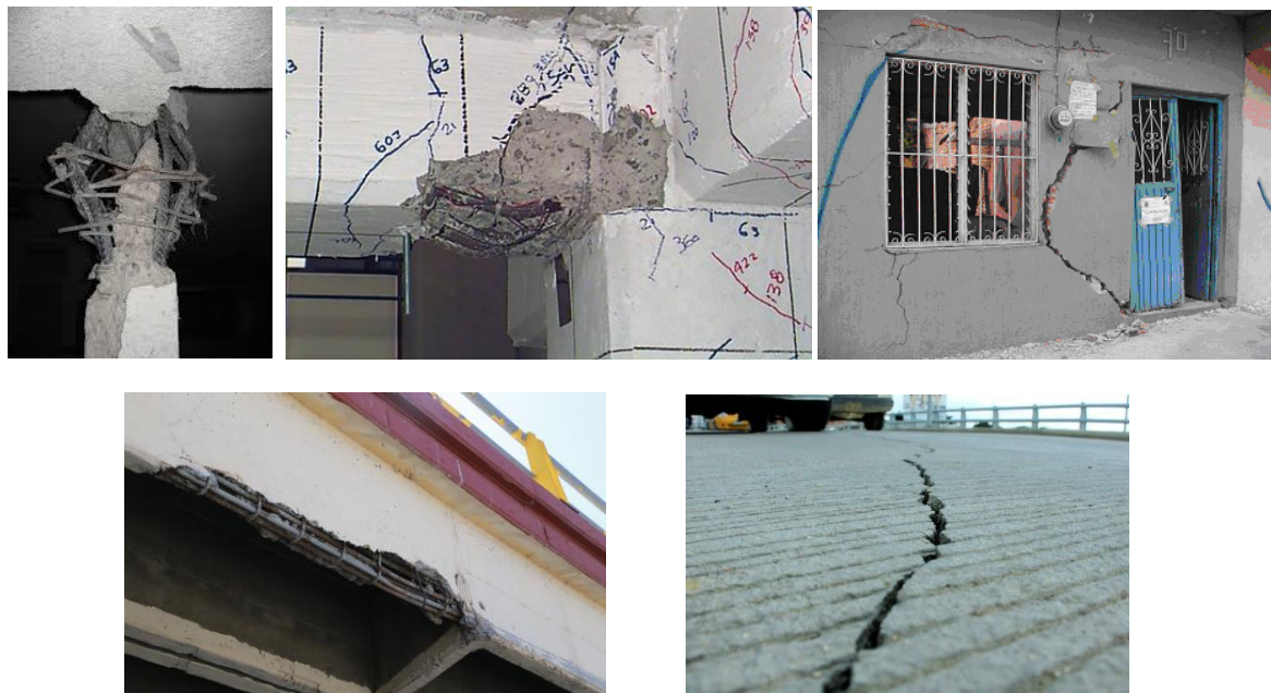
Imágenes 8 Fallas Estructurales
