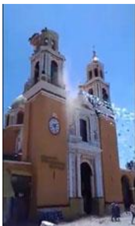
Fig 15. Desplome Cupulin sur 1 norte
