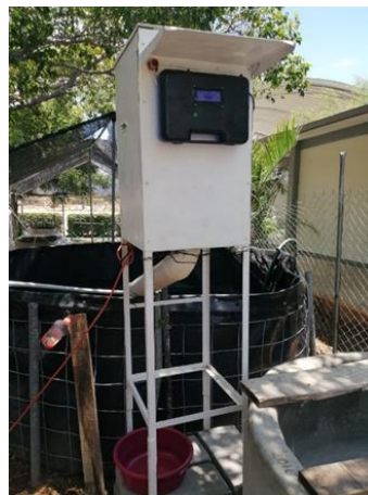
Figura 8. Sistema de alimentación automatizado instalado en los estanques del Instituto Tecnológico de Salina Cruz.
