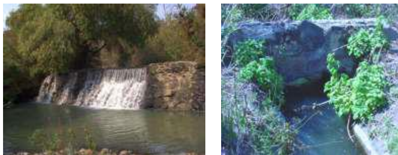
Fig. 1 Represa o bocatoma y marco de mampostería construidos en el año de 1743.
