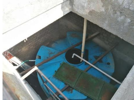
Figura 3. Cisterna con agua tratada. Creación propia.
