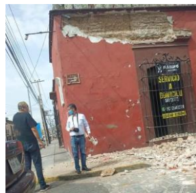
Figura 6. Daños en los acabados del inmueble de un negocio ubicado en Oaxaca. Fuente: Usuario de redes sociales
