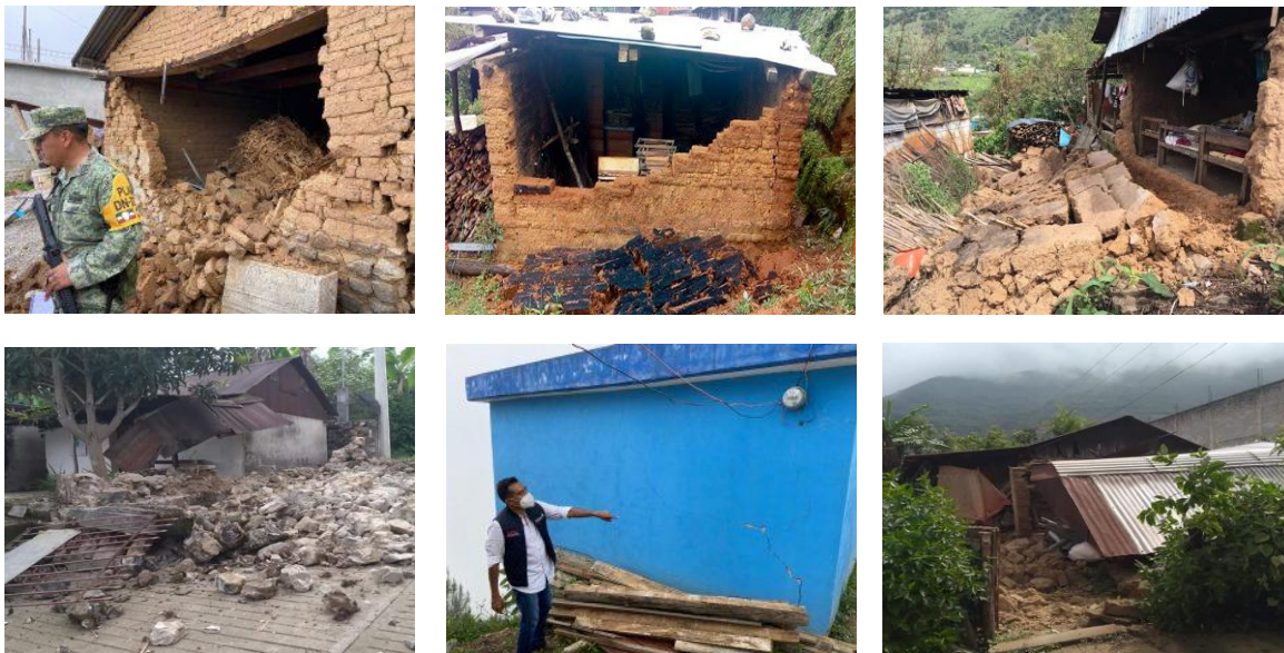
Figura 3. Daños severos en viviendas de Oaxaca altamente vulnerables sísmicamente. Fuente: Gobierno de Oaxaca y usuarios de redes sociales
