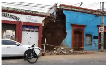
Figura 10. Afectaciones a negocios en la capital de Oaxaca debido a daños en un edificio vecino. Fuente: Noticias Hey Oaxaca
