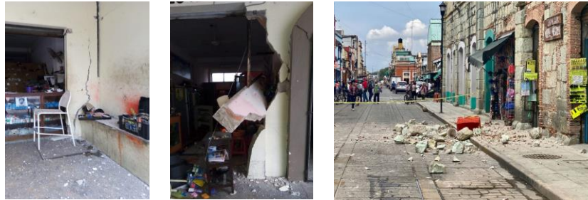
Figura 8. Interrupción de negocios por daños en las edificaciones: A) Desprendimiento de material en el inmueble de un negocio de Huatulco. Fuente: Diario el Fortín, B) Grietas en el inmueble de un negocio de Huatulco. Fuente: Diario el Fortín y C) Desprendimiento de material en un inmueble con varios negocios establecidos (papelería, venta de mochilas, entre otros) en el Centro Histórico de Oaxaca. Fuente: Cuartoscuro
