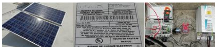
Figura 2. Conexión eléctrica de los paneles fotovoltaicos.
