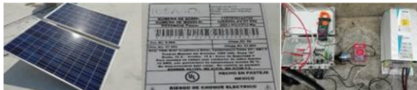
Figura 2. Conexión eléctrica de los paneles fotovoltaicos.
