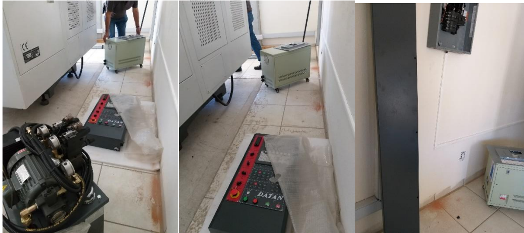
Figuras 24, 25 y 26. Partes desarmadas (control, sistema hidráulico instalación eléctrica).
