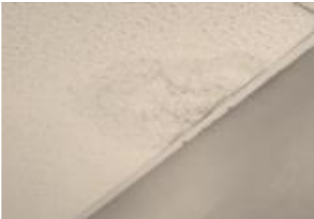
Ilustración 4. Desperfecto en instalaciones
