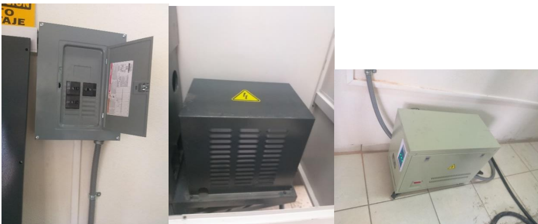
Figura 35. Caja de interruptores. Figura 36. Enfriador. Figura 37. No Break.
