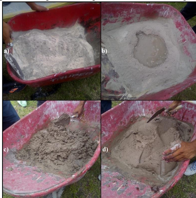
Figura 2. Obtención de la mezcla: a) Vertido de los compuestos; b) Vertido de agua; c) Mezclado; d) Mezcla final
