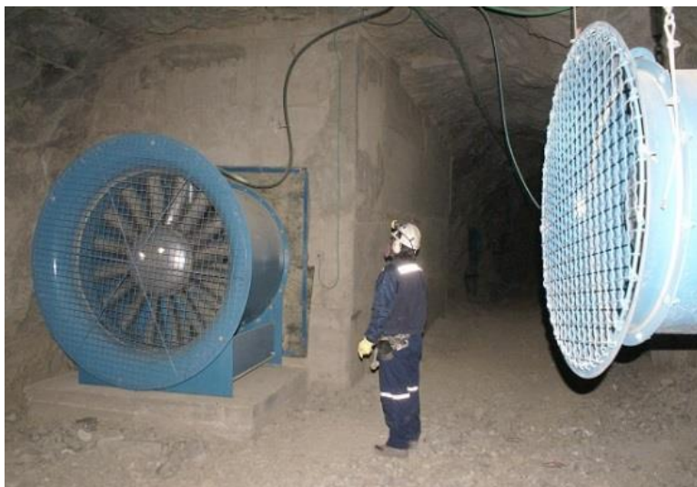
Figura 3.- Ventilador industrial en mina
