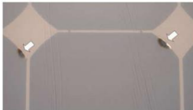
Figura 5. Módulo que presenta puntos calientes sobre los bordes de las esquinas superiores
