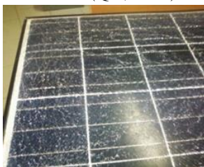
Figura 4. Módulo fotovoltaico presentando rupturas del vidrio
