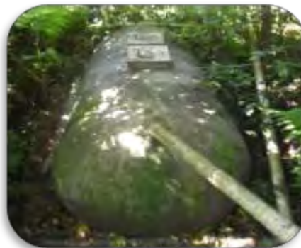
Fig. 18. Biodigestor en funcionamiento.
