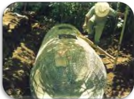
Fig. 17. Estructura del biodigestor en la base.
