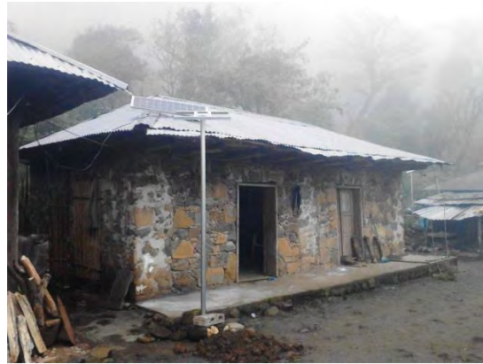
Figura 3. Sistema instalado y operando en casa habitación, en el municipio de Yahualica, estado de Hgo..
