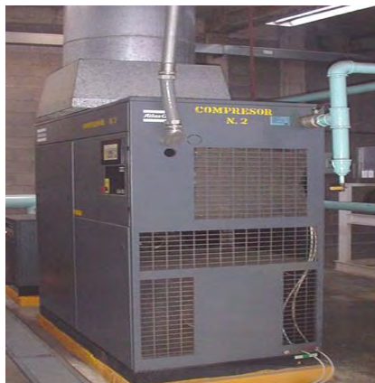
Fig. 2. Control del proceso del compresor
