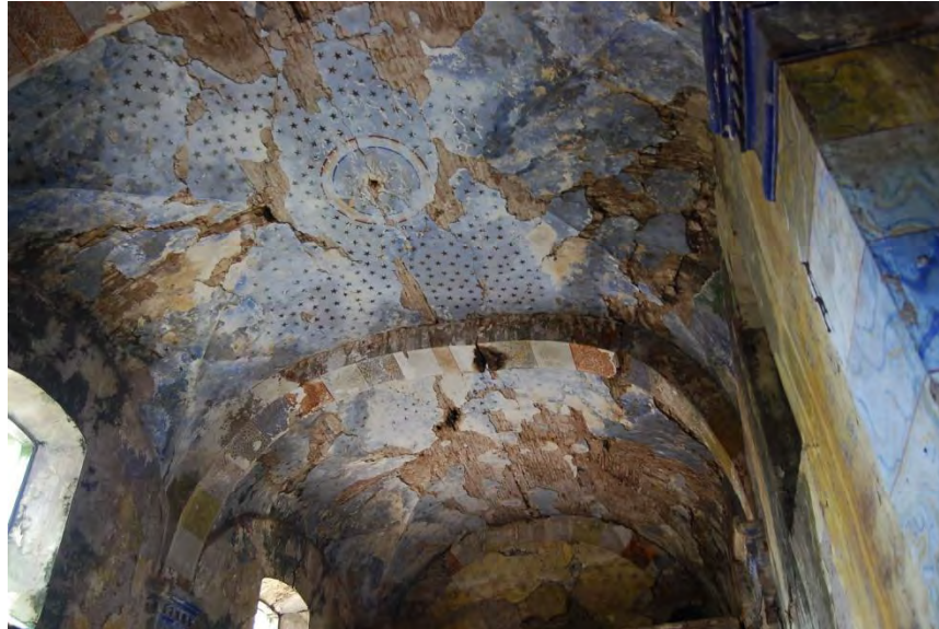
Foto 2. Daños en la cubierta de la capilla, ocasionados por agrietamientos de la bóveda y agravados por las filtraciones de agua. Se aprecia la deformación del arco de manera alarmante. Fuente propia.
