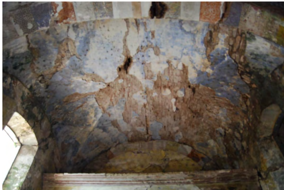
Foto 1. Daños en la cubierta de la capilla, ocasionados por agrietamientos de la bóveda y agravados por las filtraciones de agua. Fuente propia.
