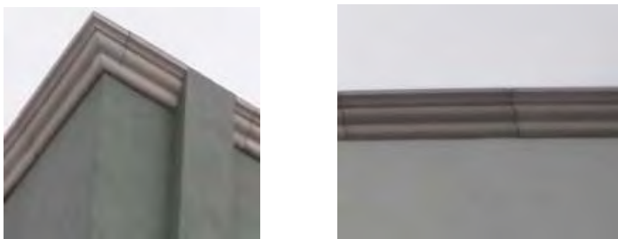
Figura 5.- Molduras de residuos de mármol en obra, actualmente tienen una edad de 2.5 años, no muestran daños, ni fallas.
