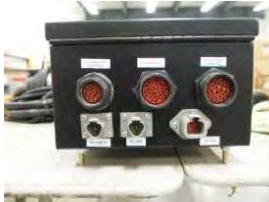
Fig. 2 Imagen de la vista exterior de una caja de control
