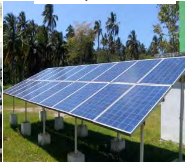
Figura 4 Paneles fotovoltaicos instalados en la UPGM.
