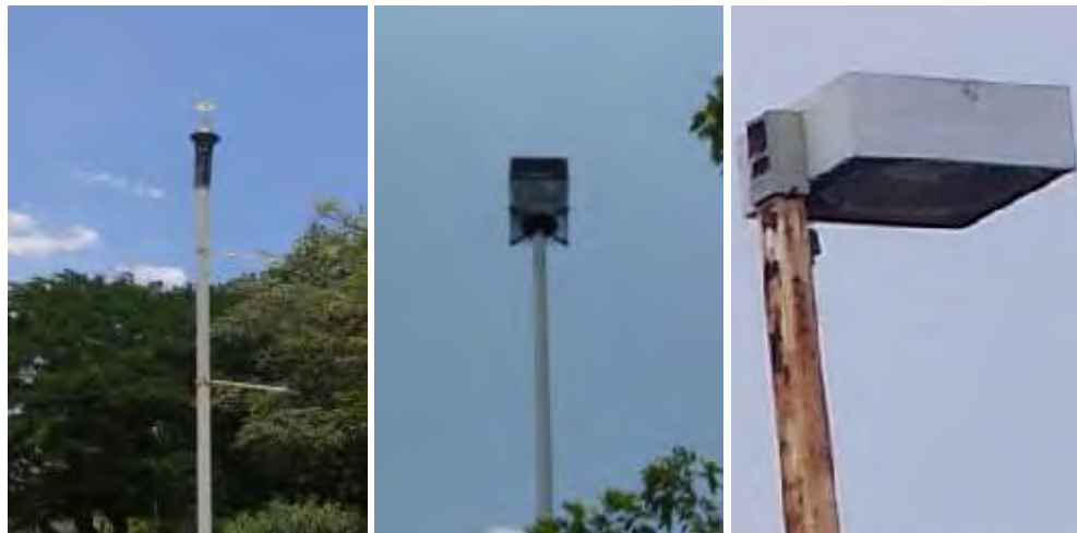
Figura 2. Lámparas de alumbrado exterior en deterioro.
