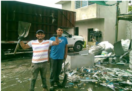
Figura 6. Los trabajadores sin equipo de seguridad
