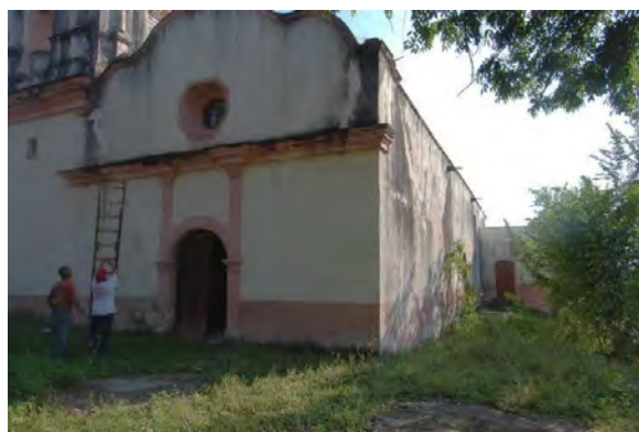
Figura 3. Imagen den grado de deterioro que llegó a tener la iglesia. Fuente: Ventura Vega Ozieri 2015.
