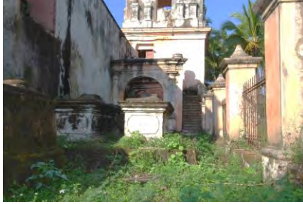
Figura 5. Imagen den grado de deterioro que llego a tener El Panteón Familiar Fuente: Ventura Vega Ozieri 2015.
