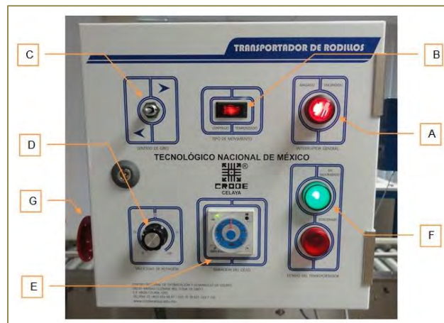
Figura 6 Identificación de los elementos en el panel de control.
