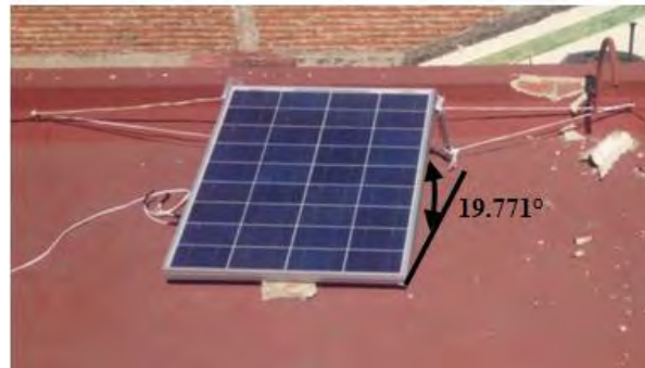
Figura 6. Sistema fotovoltaico fijo.
