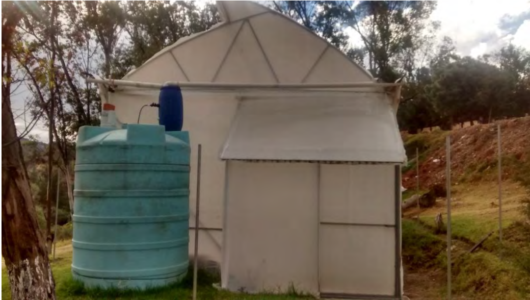
Figura 2. Instalación de filtro, cisterna de 10,000 litros y sistema de bombeo
