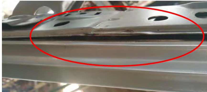
Figura 3. Punto de soldadura mal colocado por el operador por no seguir el estándar.
