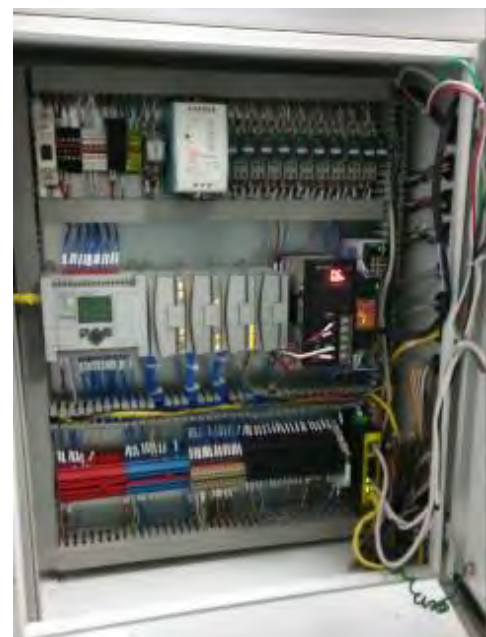
Figura 6. Tablero de control eléctrico
