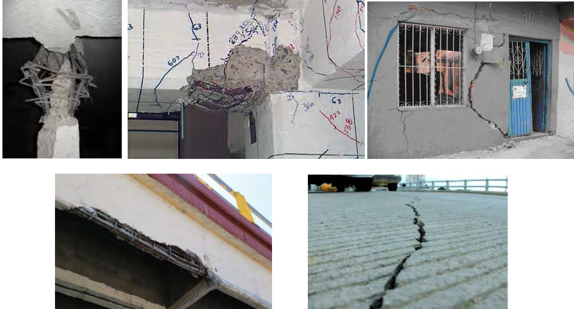
Imágenes 8 Fallas Estructurales
