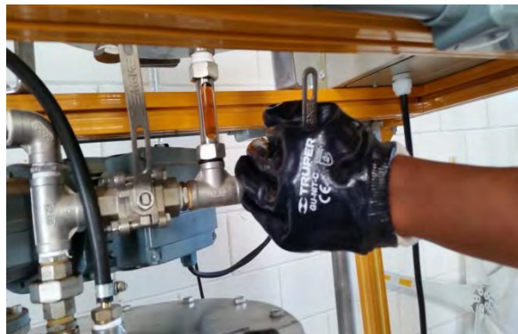
Figura 8. Apertura de válvula del tanque de decantación para separar glicerina del biodiesel.
