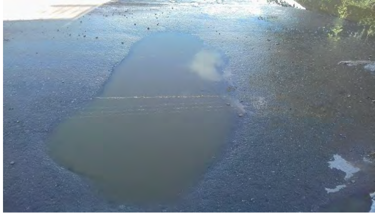
Fig.1 Calles principales de la ciudad en un estado deteriorado.
